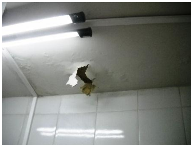
Foto 02 - Teto do lactário danificado na ocasião da auditoria.
