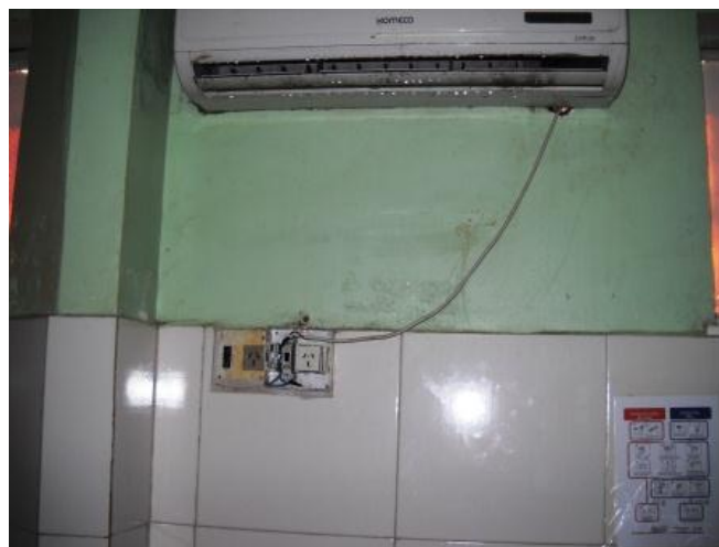
Foto 02- Fiações expostas e tomadas sem proteção.
