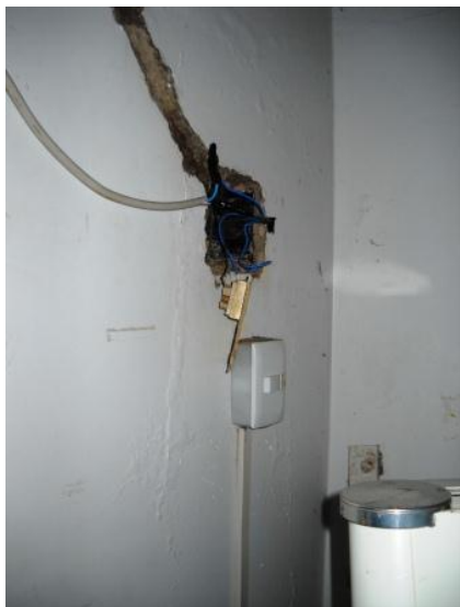
Foto 01 -Setor de diagnóstico por imagem com fiação exposta.
