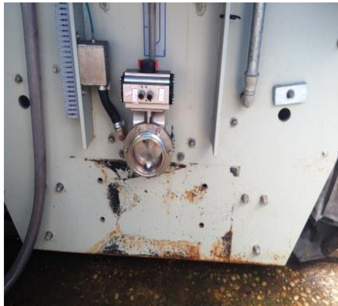
Foto 03 - Oxidação em máquina no acesso lateral do HMI.
