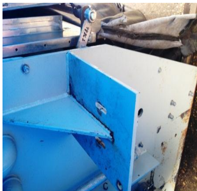
Foto 04- Oxidação em máquina no acesso lateral do HMI.
