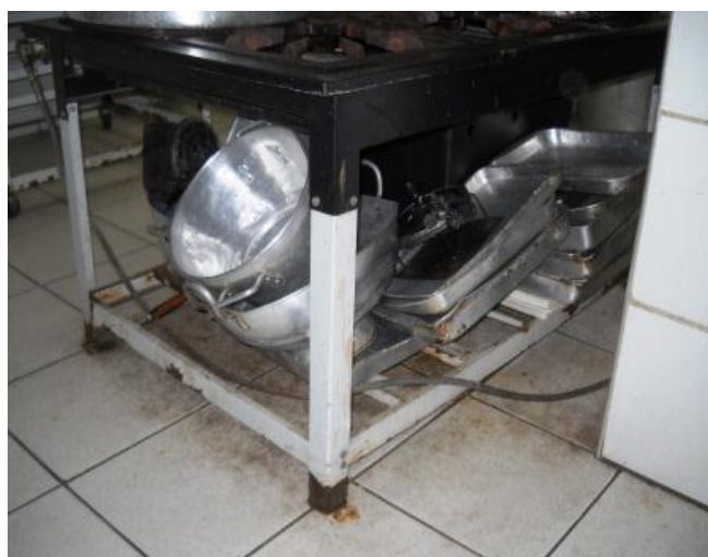
Foto 04 - Inexistência de local para guarda de utensílios.
