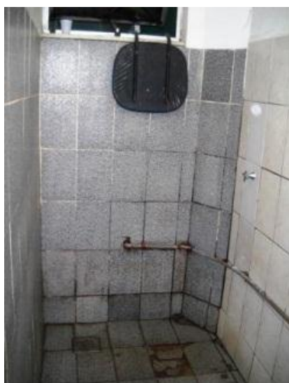
Foto 05- Banheiro em precário estado de conservação.
