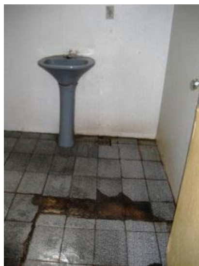
Foto 04- Piso em precário estado.
