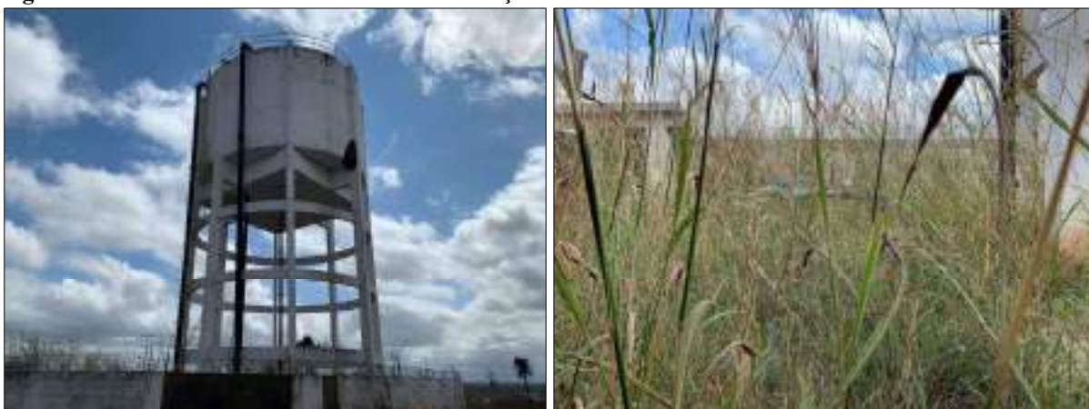
Figura 40 – RAT 19 – Loteamento Verona II. Poço e Reservatório.
