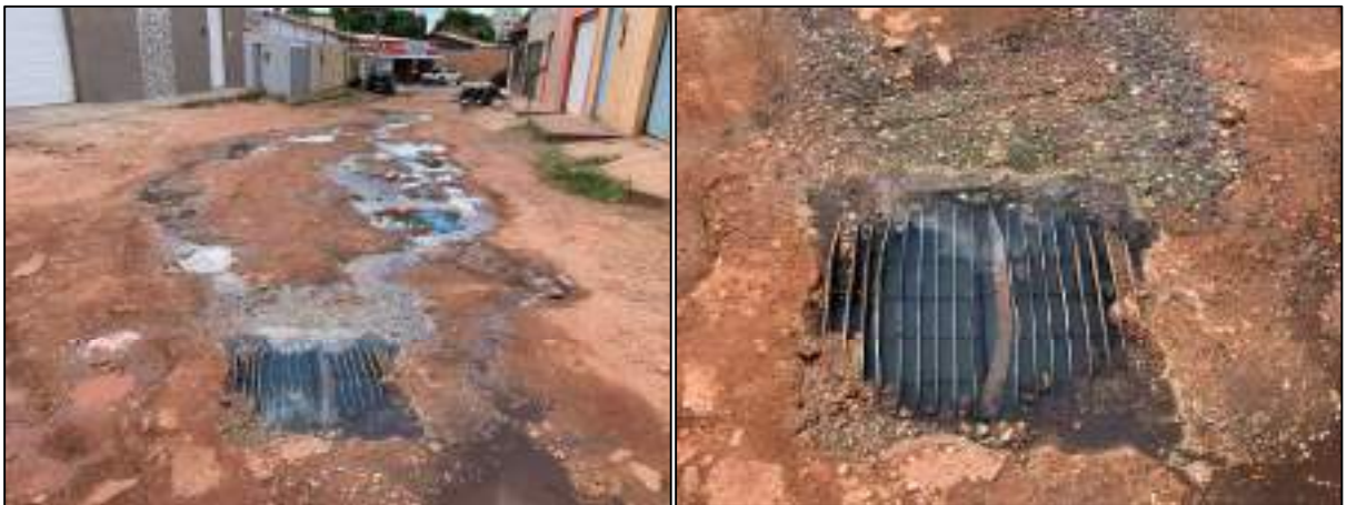
Figura 110 – Esgoto a céu aberto – Rua Colômbia – Jardim América.
