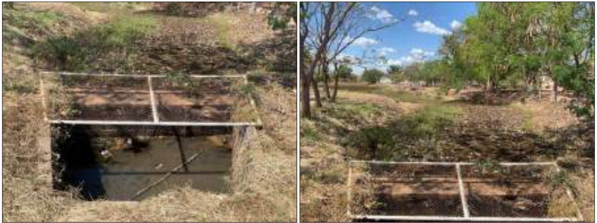
Figura 123 – Bacias de Contenção – Loteamento Imperial.
