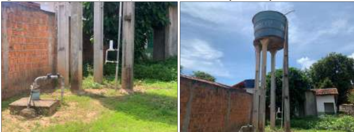
Figura 61 – SAA Vila Conceição II. Poço e Reservatório – Atendido pelo Município.
