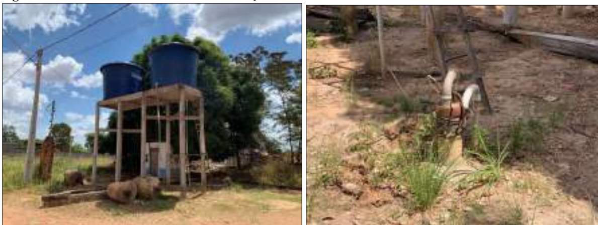
Figura 45 – RAT 24 – Bairro Bom Jesus. Poço e Reservatório.
