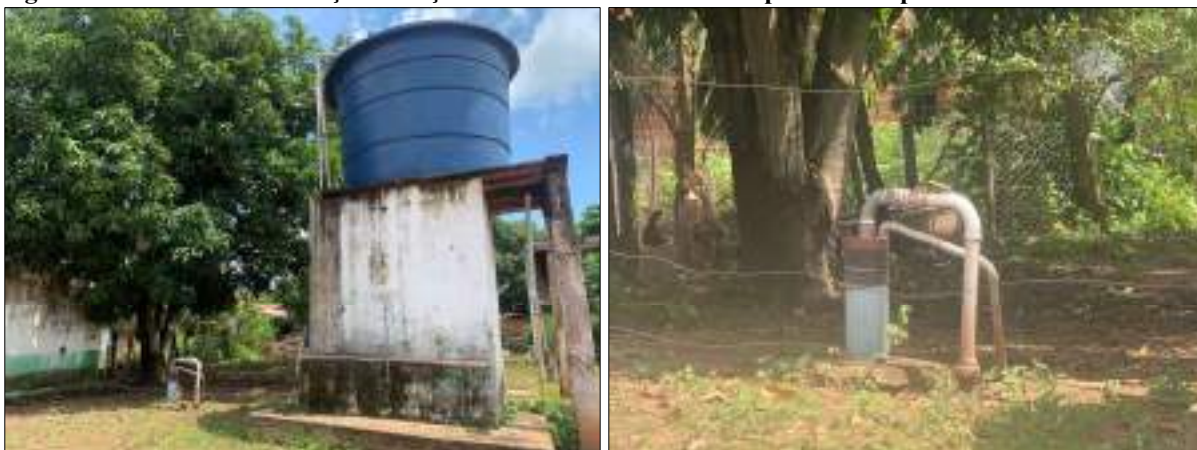
Figura 60 – SAA Vila Conceição I. Poço e Reservatório – Atendido pelo Município.
