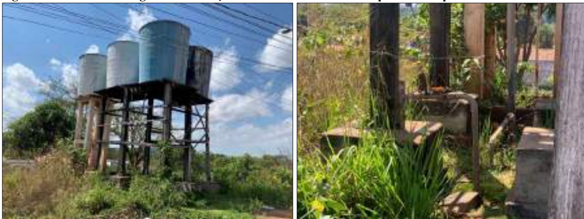
Figura 54 – RAT 33 – Lagoa Verde. Poço e Reservatório – atendido pelo município.
