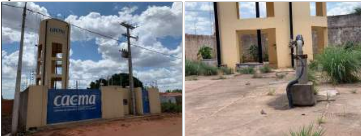
Figura 46 – RAT 25 – Jardim América. Poço e Reservatório.
