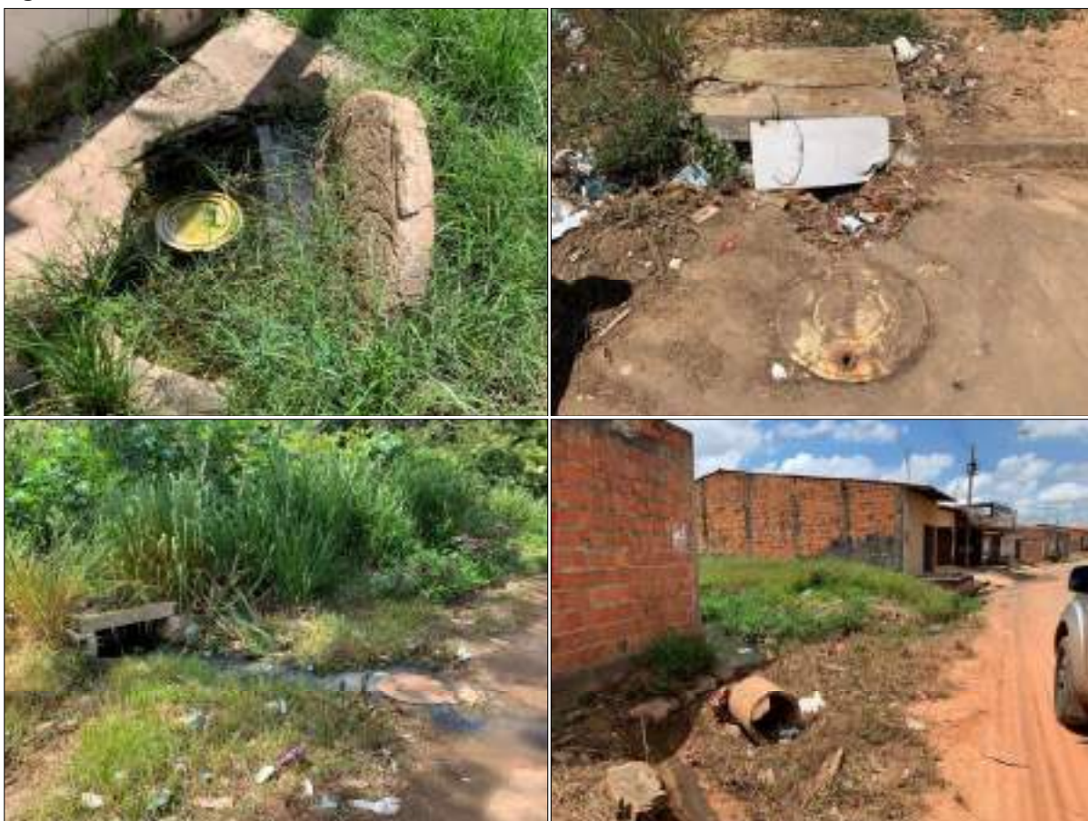
Figura 115 - Bocas-de-lobo com obstruções.
