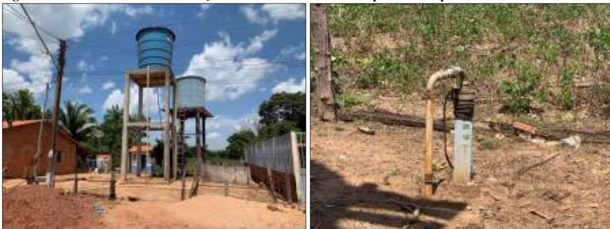
Figura 57 – RAT 36 – São Félix. Poço e Reservatório – atendido pelo município.
