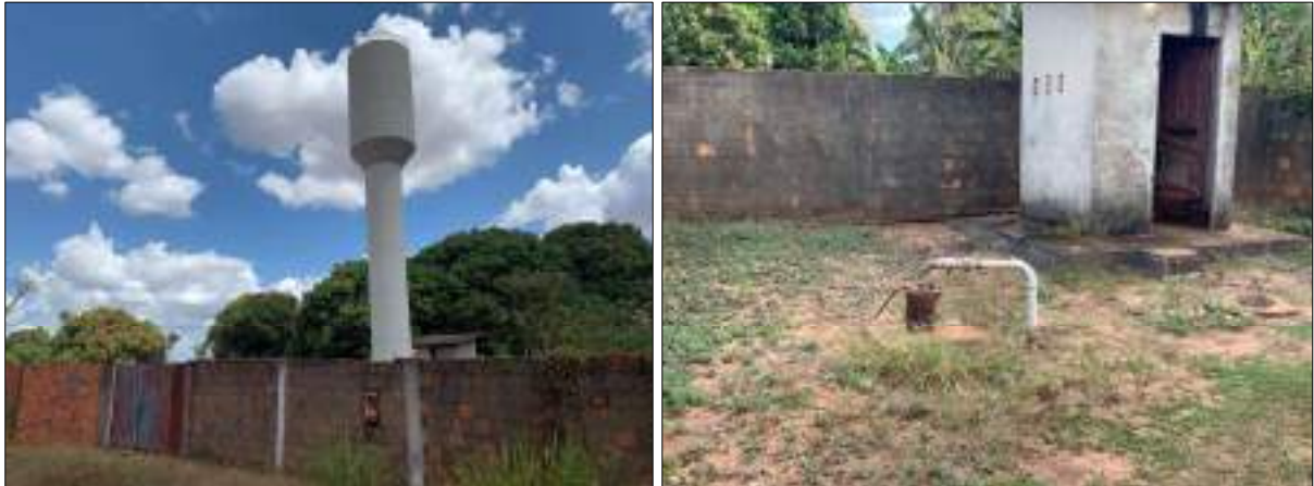
Figura 48 – RAT 27 – Camaçari. Poço e Reservatório – Atendido pelo Município.
