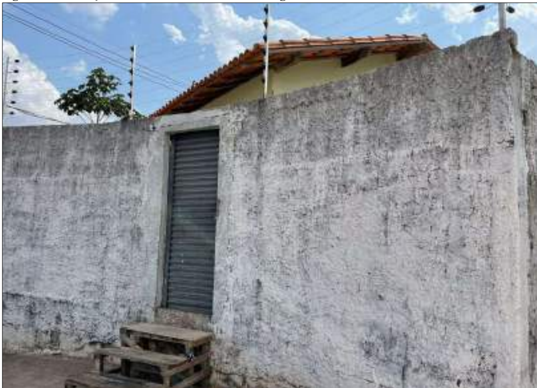
Figura 98 – Estação Elevatória Condomínio Village I.
