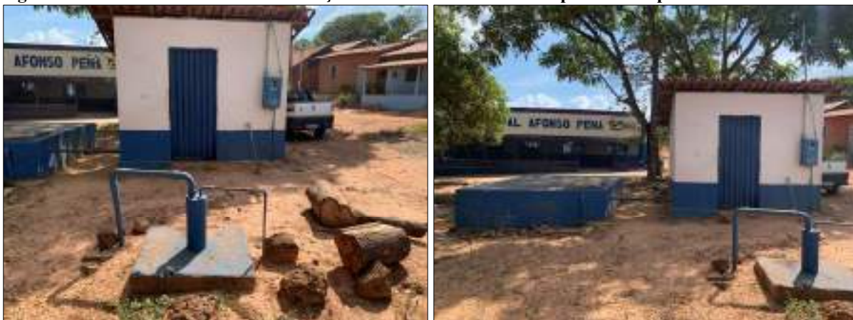
Figura 59 – RAT 38 – Povoado 1700. Poço e Reservatório - Atendido pelo Município.
