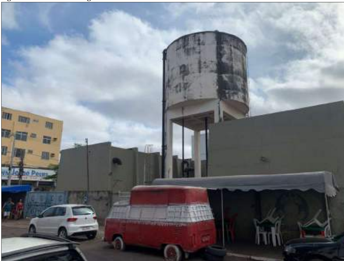
Figura 35 – RAT 14 – Dorgival X Rio de Janeiro. REL 02 e RAP 03 – Reservatório.
