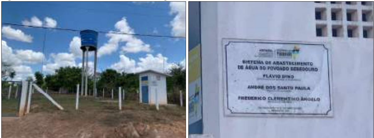
Figura 49 – RAT 28 – Povoado Bebedouro – Operação CAEMA. Poço e Reservatório.
