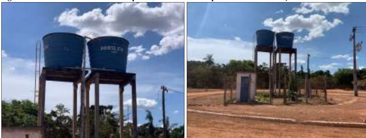
Figura 33 – RAT 11 – Loteamento Imperial – Administrado pelo Condomínio. Poço e Reservatório.
