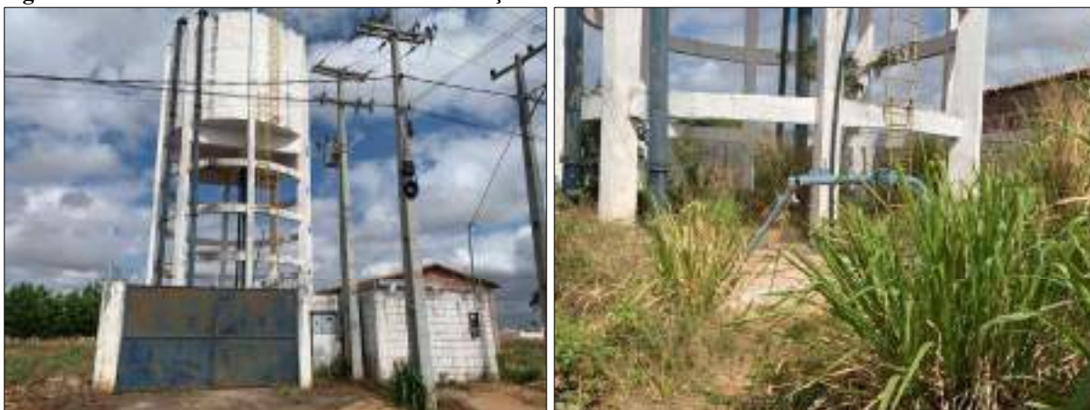
Figura 39 – RAT 18 – Loteamento Verona I. Poço e Reservatório.
