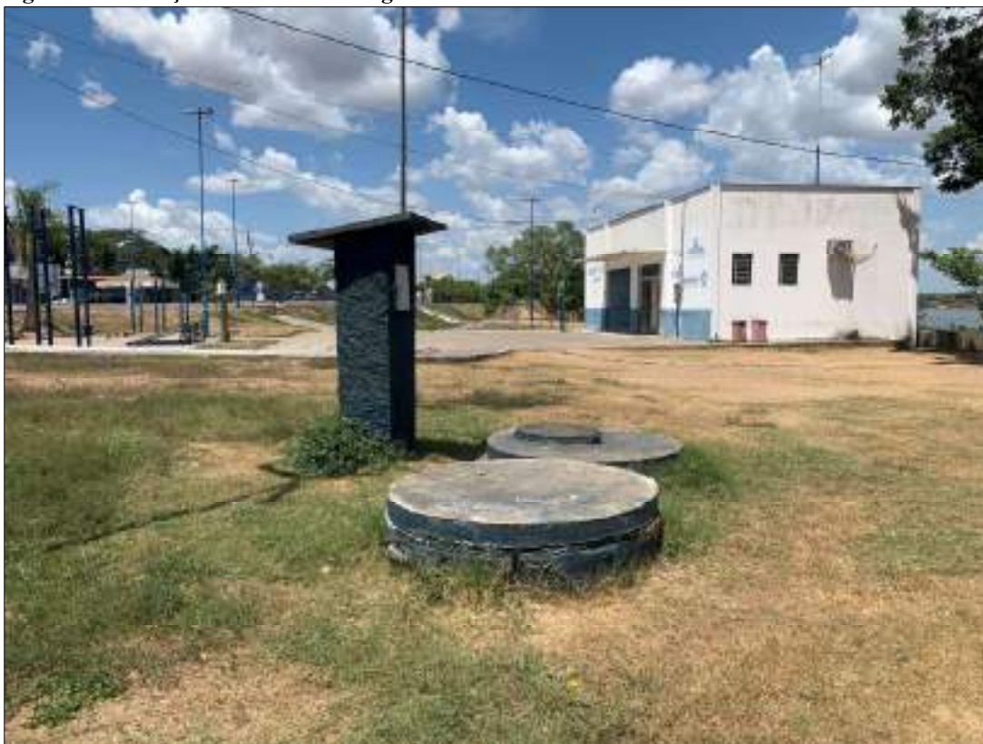
Figura 93 – Estação Elevatória de Esgoto 09.
