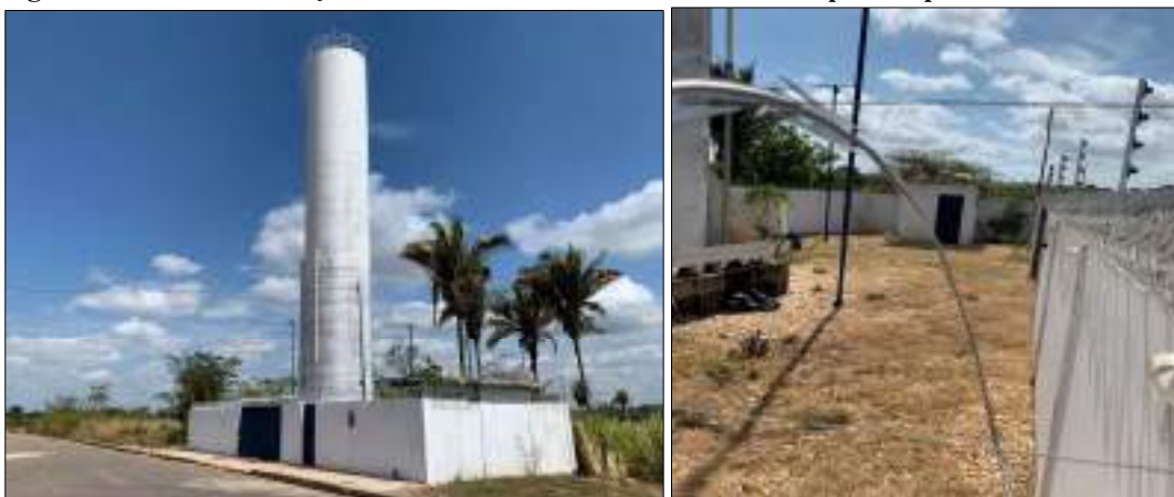
Figura 26 – RAT 04 – Poço e Reservatório. LOT. Santa Clara – Operado pelo Condomínio.
