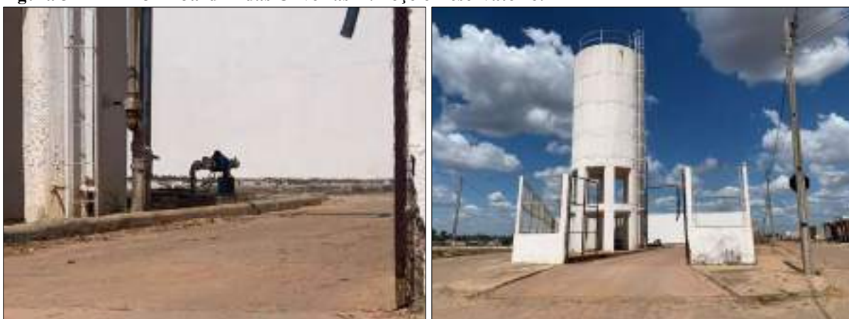
Figura 52 – RAT 31 – Jardim das Oliveiras II. Poço e Reservatório.
