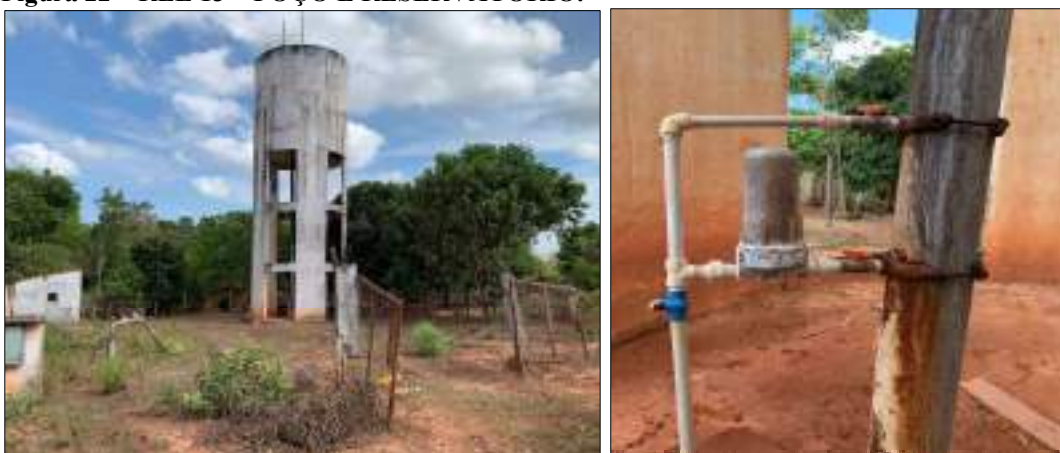
Figura 22 – REL 13 – POÇO E RESERVATÓRIO.
