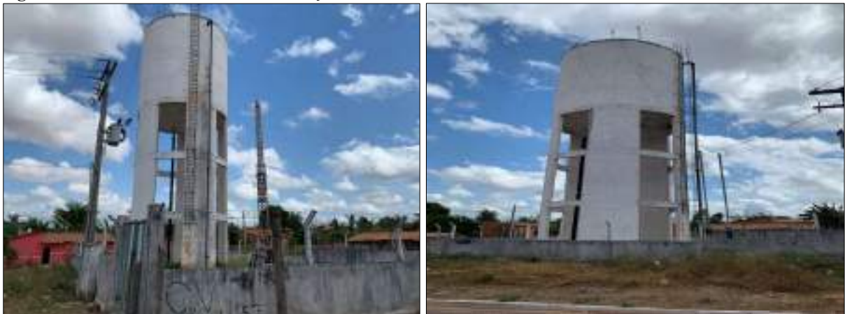
Figura 42 – RAT 21 – DOM Afonso. Poço e Reservatório.
