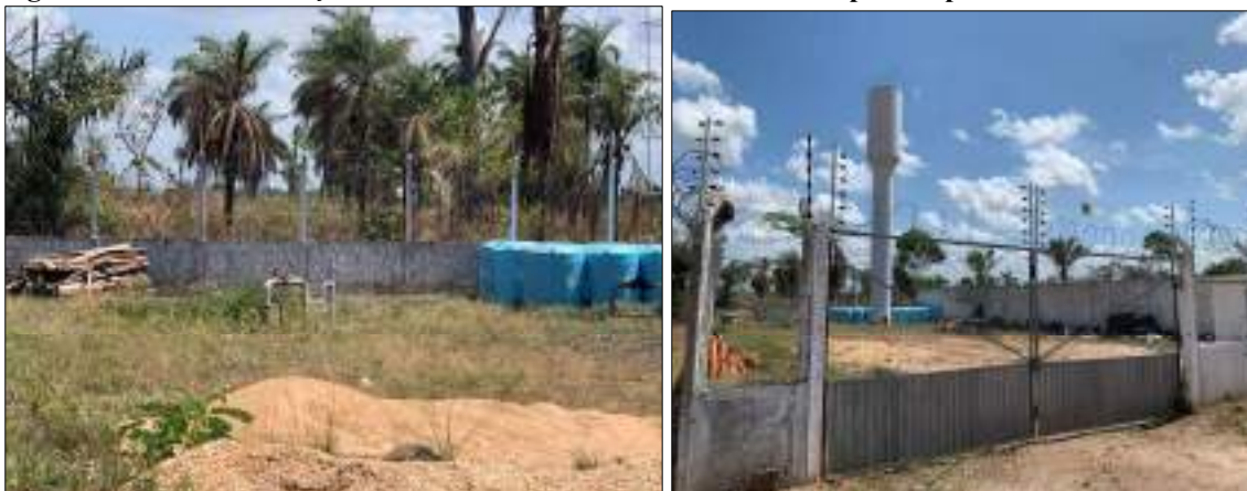
Figura 27 – RAT 05 – Poço e Reservatório LOT. Cidade Jardim– Operado pelo Condomínio.
