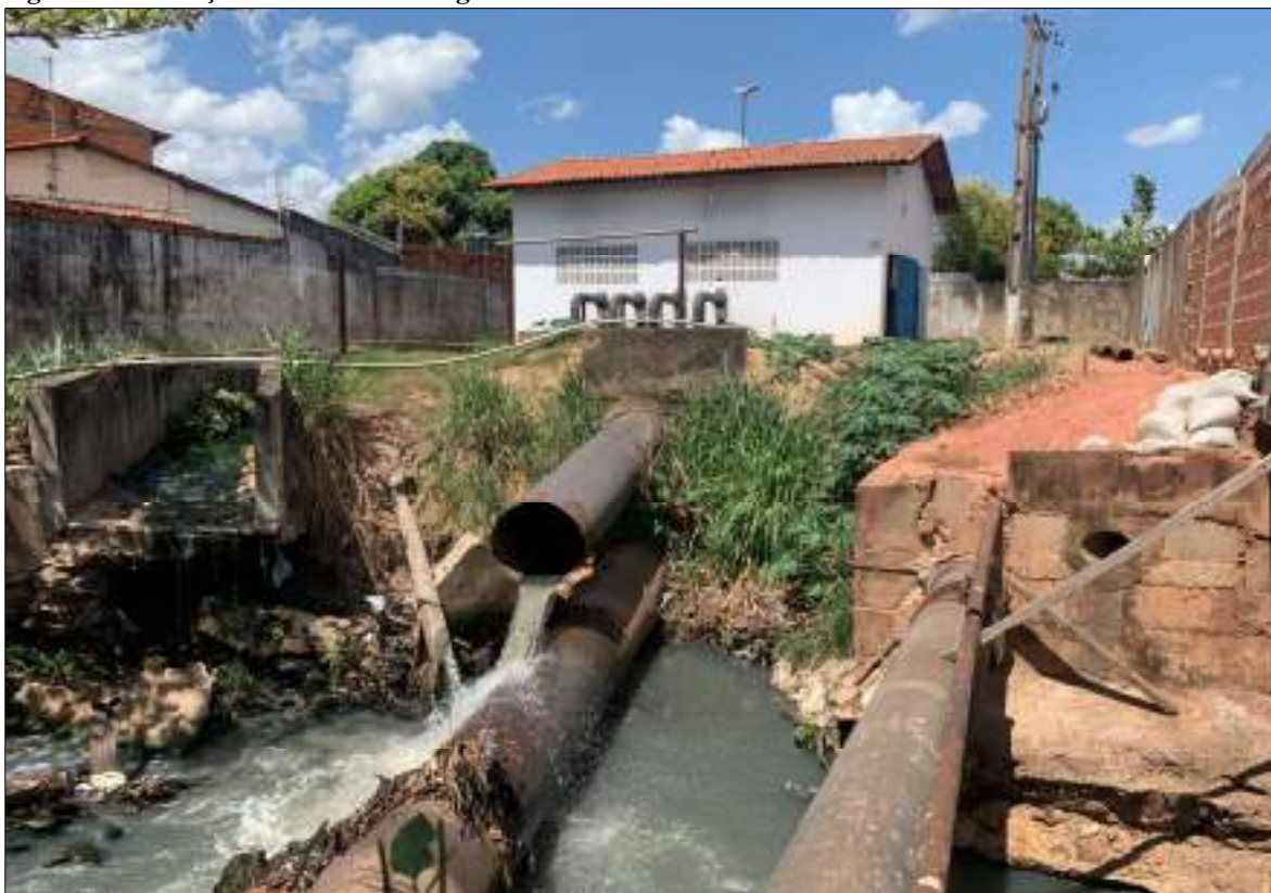
Figura 91 – Estação Elevatória de Esgoto 06.
