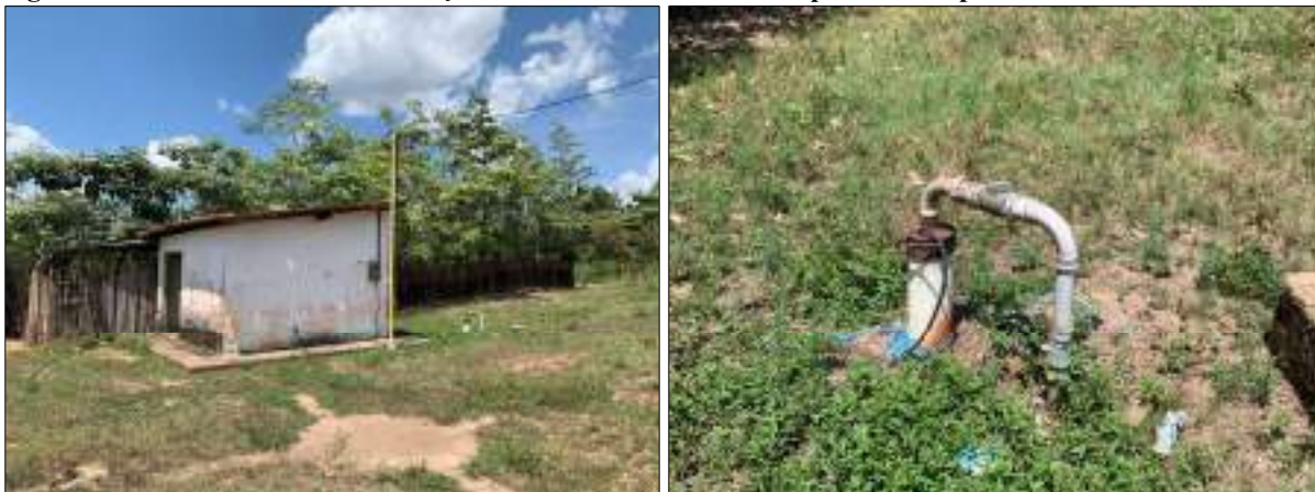
Figura 58 – RAT 37 – Petrolina. Poço e Reservatório – Atendido pelo Município.
