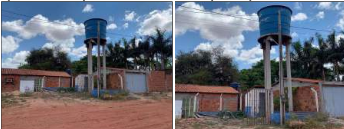
Figura 50 – RAT 29 – Lagoinha. Poço e Reservatório – atendido pelo município. Poço e Reservatório.
